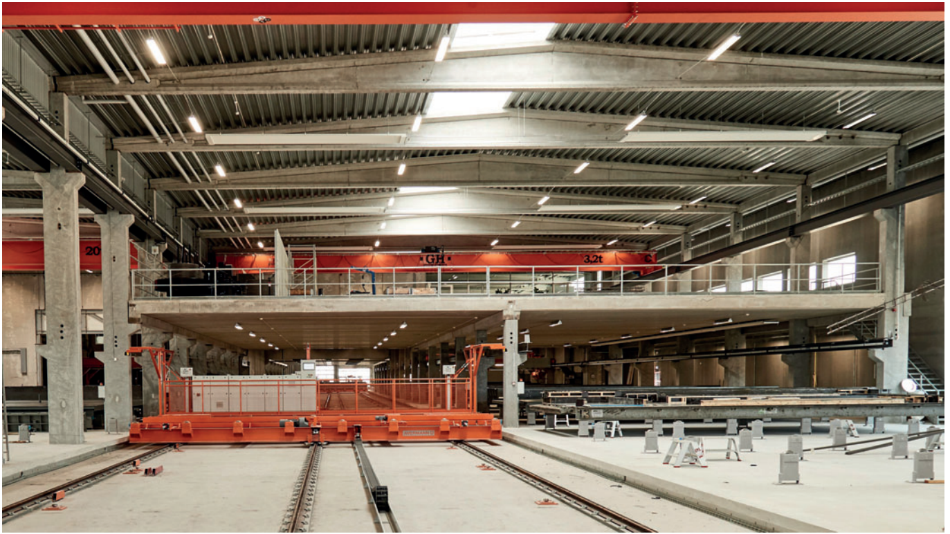
Fig. 3: Transport des palettes avec le chariot de transfert central sur rails.
