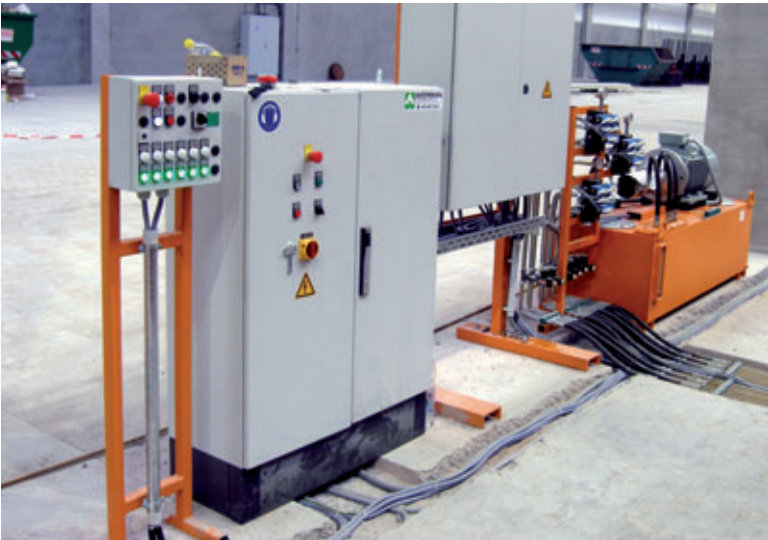
Estación de mando para el control del sistema hidráulico y los vibradores
