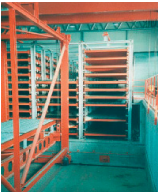
HBA in einer Grube angeordnet mit offener Härtekammer
