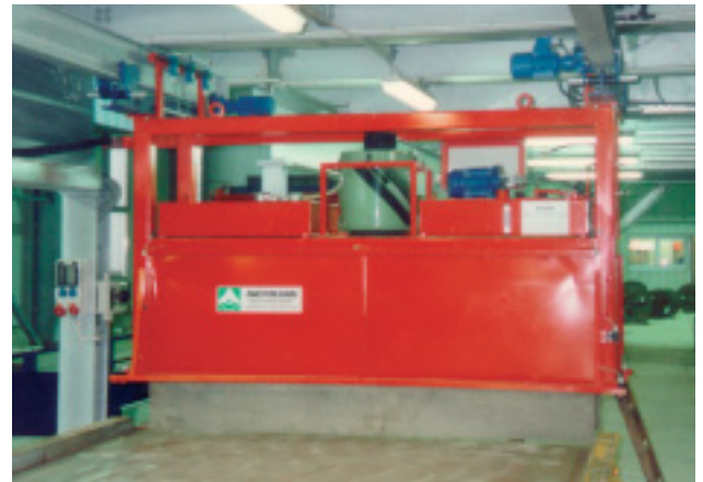
Verfahrbare Einölmachine mit Brückenfahrwerk
